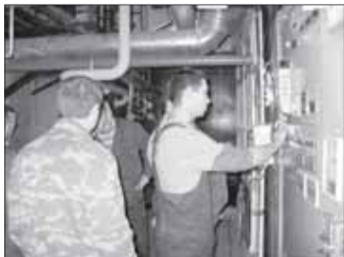
Пусковые работы в котельной
