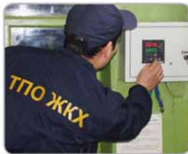
Программирование автоматики котлов
